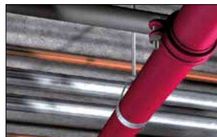
Linea sprinkler ancorata con collare FRSL
