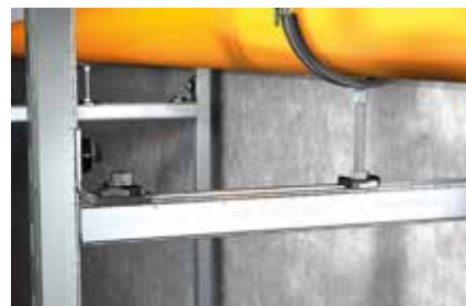
Tubazione fissata su telaio
