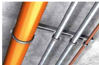
Fissaggio tubazioni a soffitto
