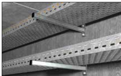
Canale elettriche su mensole ALK
