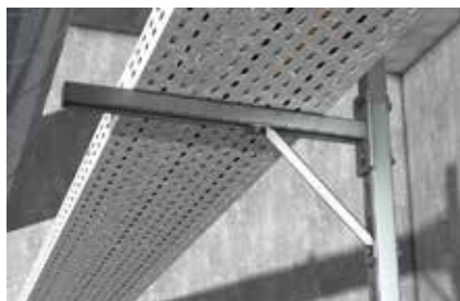
Canalina elettrica fissata su struttura a mensola
