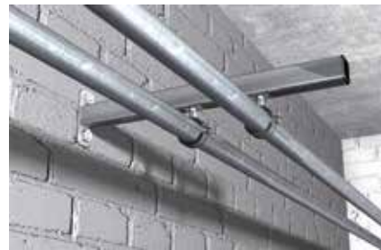
Tubazione pesante su mensola
