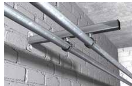
Tubazione pesante su mensola
