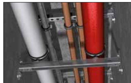
Installazione in corridoio con FUS
