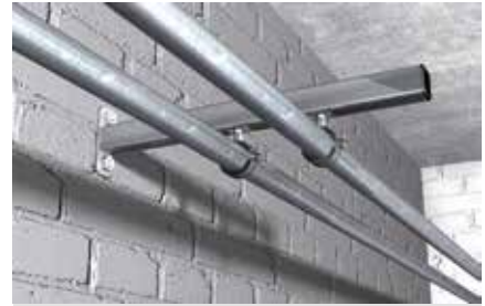
Tubazioni su mensole
