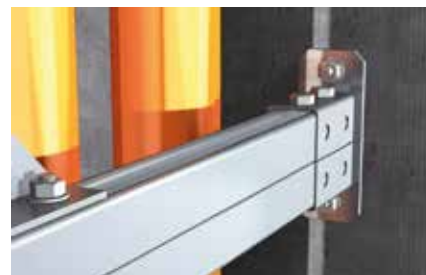
Installazioni di batterie di tubi
