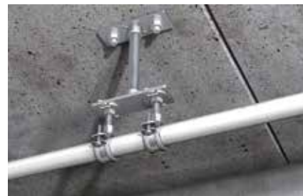
Tubazione in plastica con punto fisso
