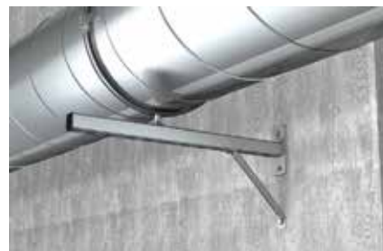
Canale d'aria fissato su mensola a parete
