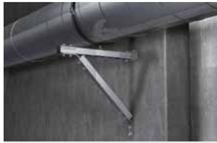
Condotta d'aria circolare su mensola
