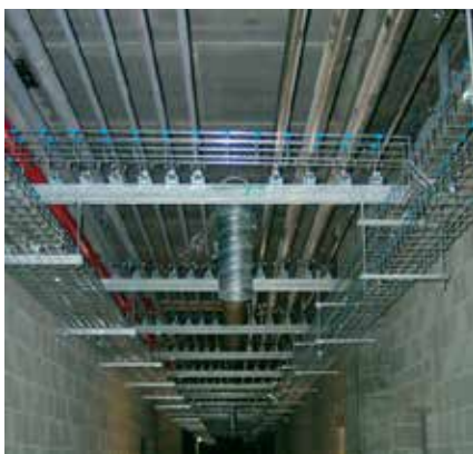
Impianto complesso in struttura strategica. La scelta dello staffaggio antisismico deve considerare le esigenze della normale funzionalità dell'impianto, come ad esempio consentire la dilatazione dei tubi.
